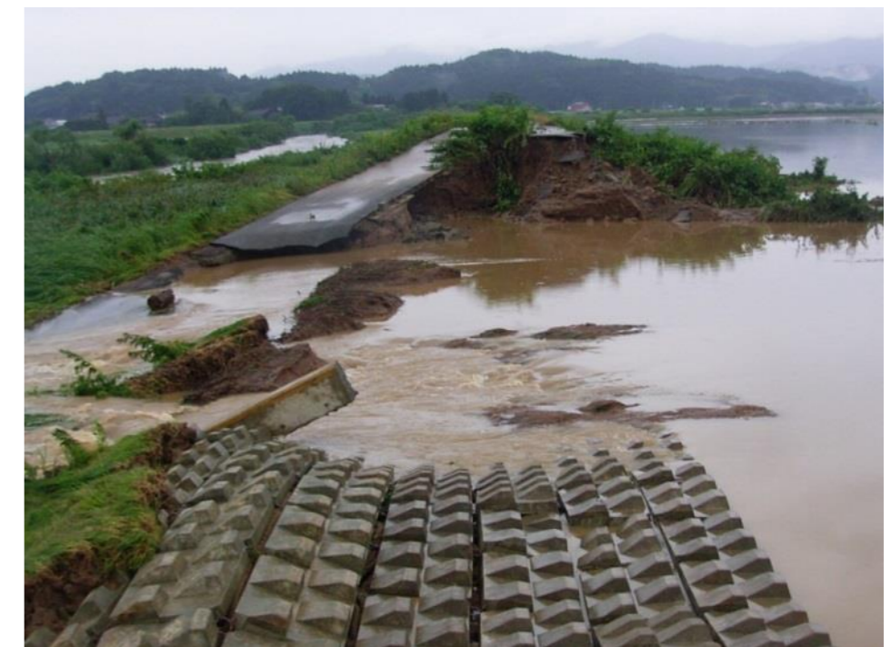
破堤後の状況
