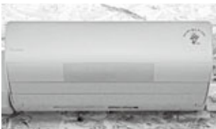
海士剝公民館に設置されたエアコン
