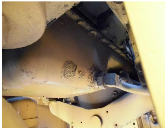
エンジンオイルパン腐食
