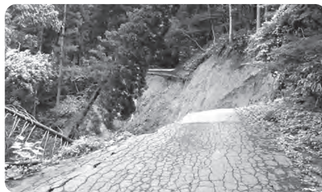
道路崩落 葛岡線（大内地域）
