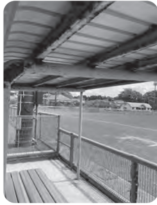
腐食の進んだダグアウト
