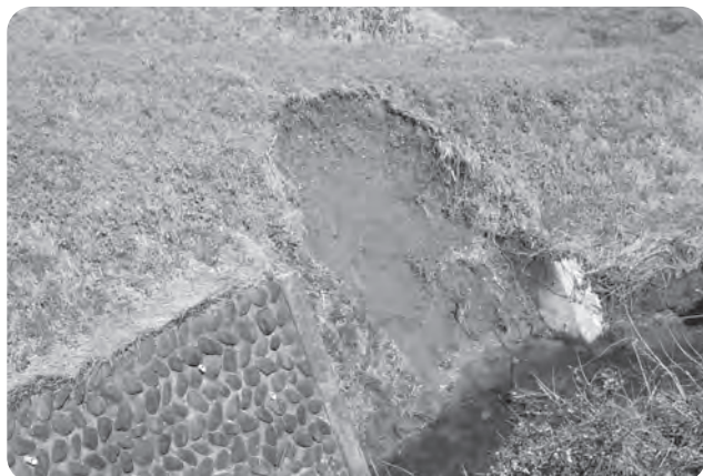
本荘地区小屋川の法面崩落
