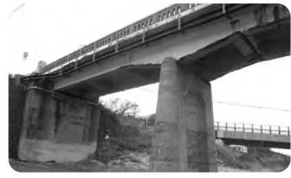
老朽化が進む橋
