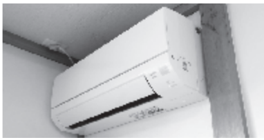
松美町公民館に整備されたエアコン
