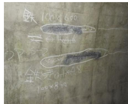
アーチ部の鋼材腐食
