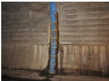
アーチ部の漏水（滴水～流下）
