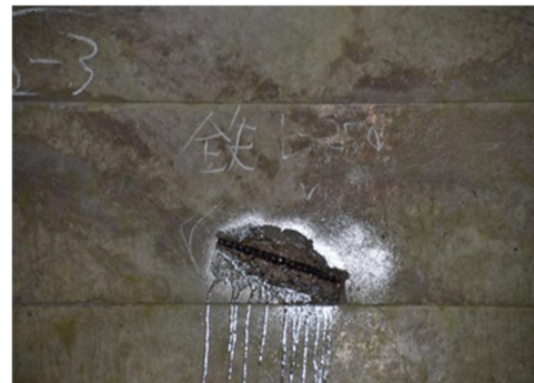
アーチ部の鉄筋露出「Ⅱa」
