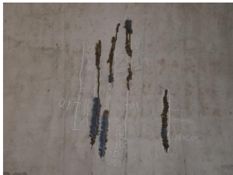
アーチ部のうき・鉄筋露出「Ⅲ」
