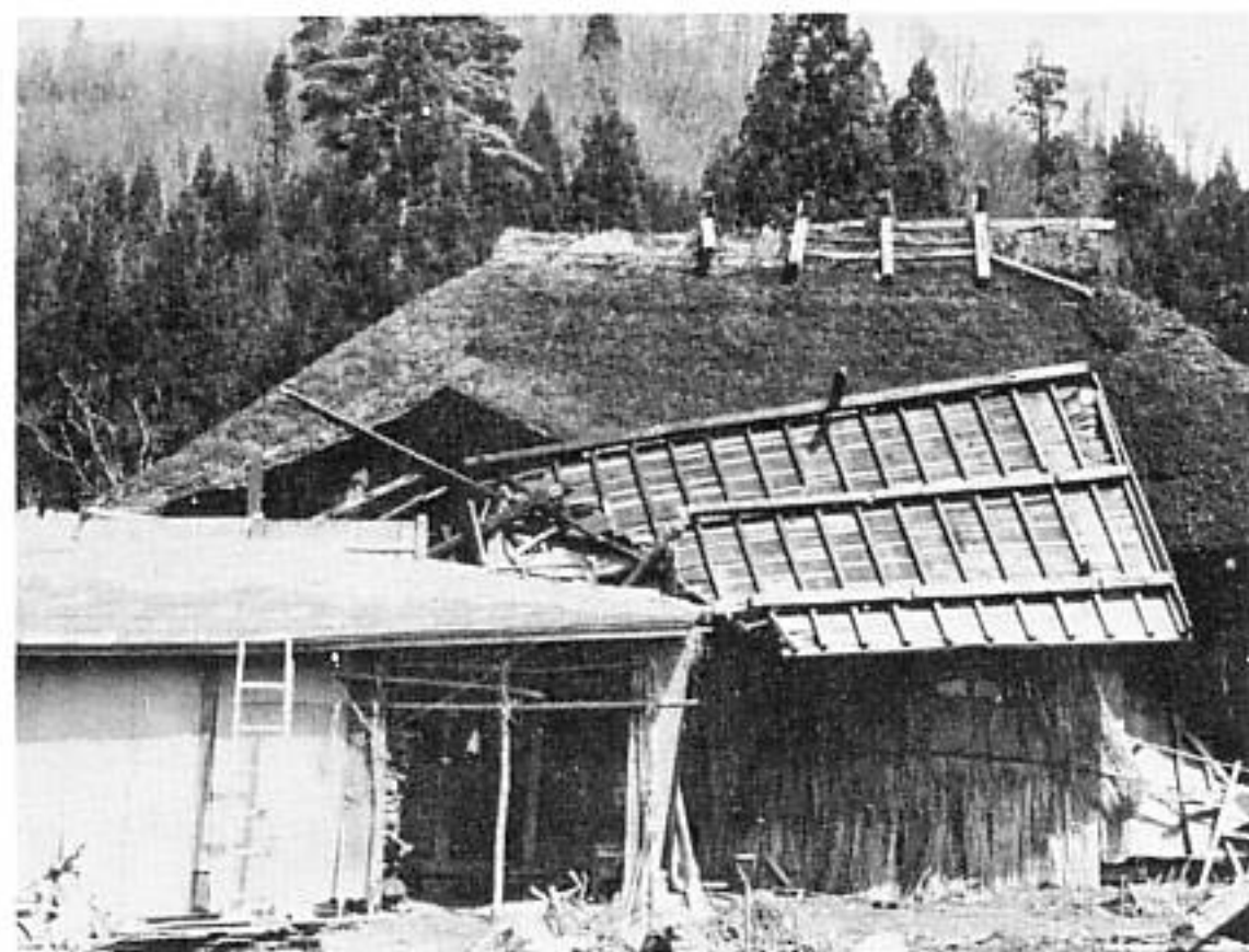
強風に飛ばされた作業小屋の屋根が住家にあたり、柱を折る
