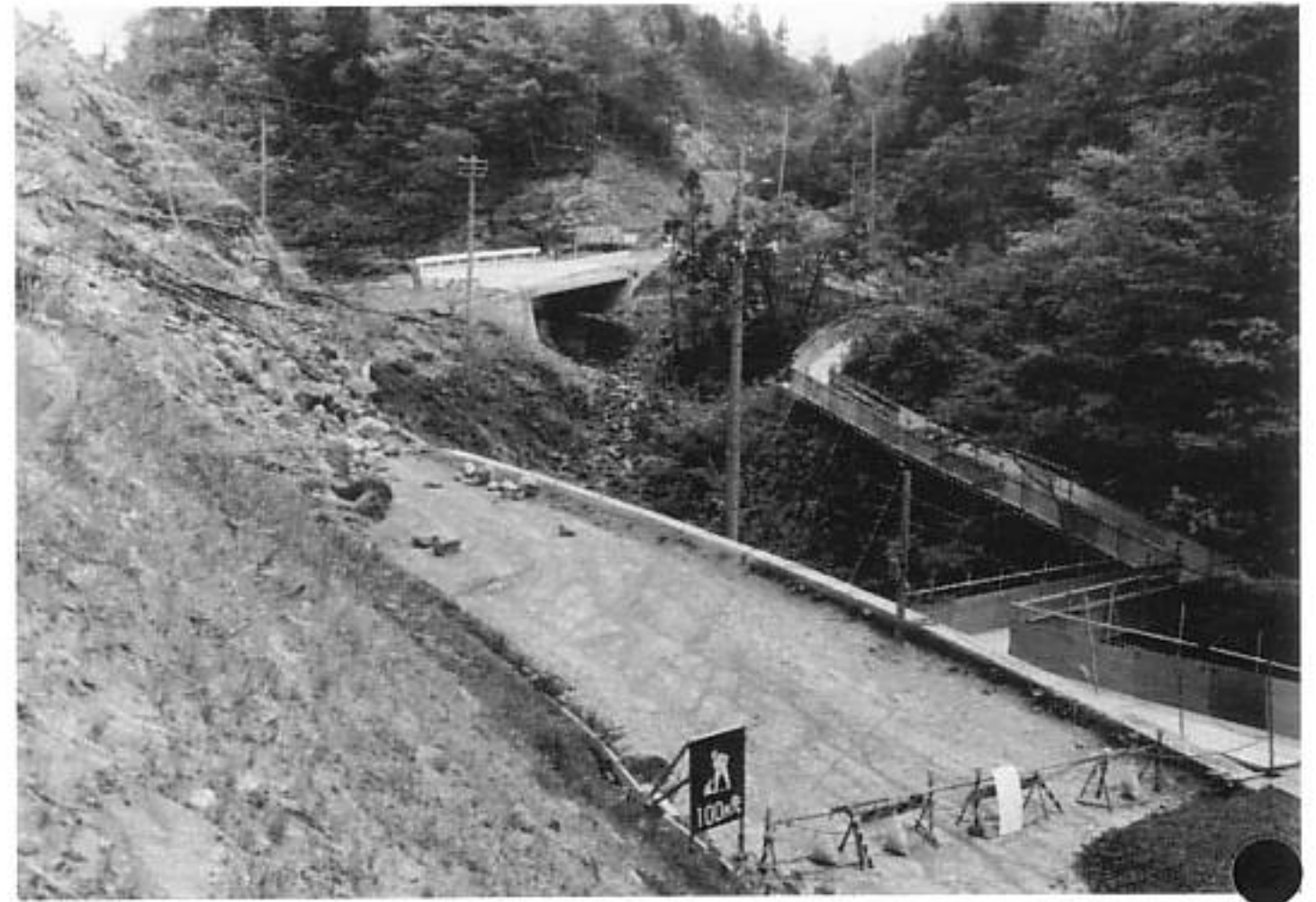
土砂崩れが発生した高村線・樽水地内（右は仮設された歩行者用通路）
