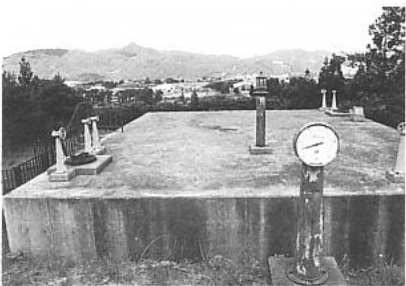
④ 第三配水池 (台山) 各配水池を経て二つの源水が合流します。
