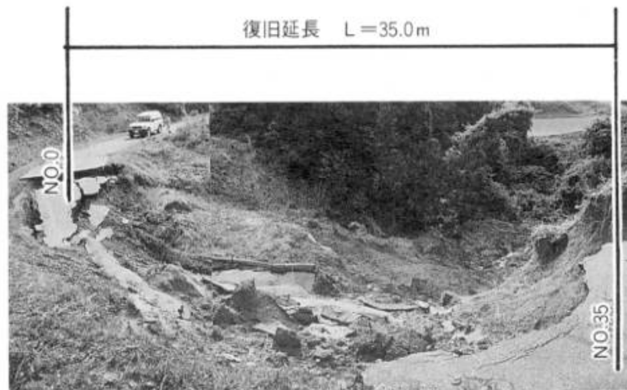
▲災害発生！道路が危ない！
