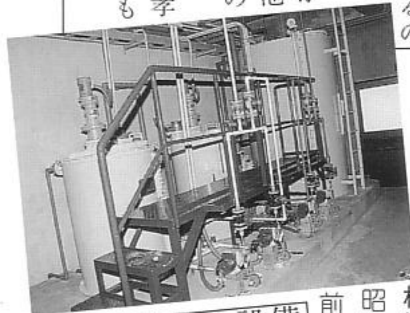
薬品注入設備
