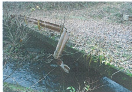
防護柵の損傷
