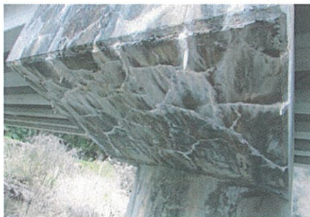
橋脚の遊離石灰を伴うひびわれ
