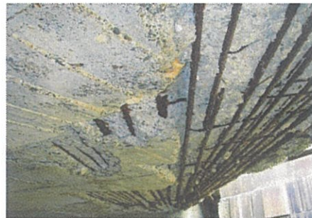
床版の鉄筋露出
