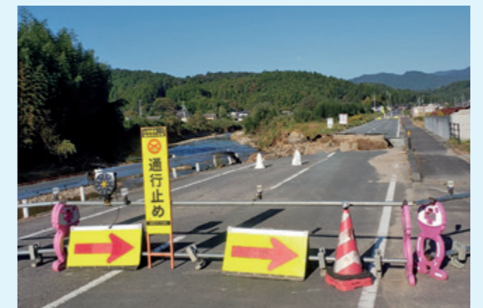
路肩が崩落し、通行止めとなった道路(10/17いわき市)
