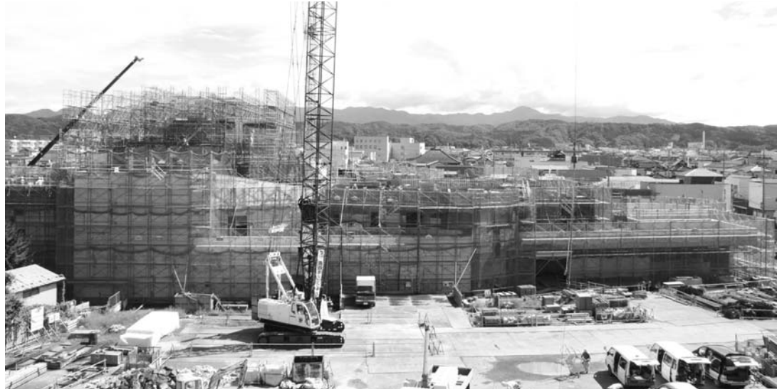
西側(本荘公園方面)から見た建設中の施設。左側がホール部分 協力:国土交通省鳥海ダム調査事務所
