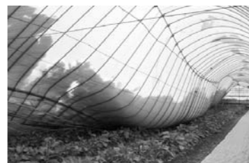
ビニールハウスが損壊(同)
