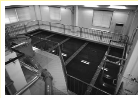
浄水管理棟には着水井、高速凝集沈殿池、ろ過池、薬品注入室、活性炭注入室、滅菌室、水質試験室、制御盤室、機械室、自家発電室などが配置されています。
