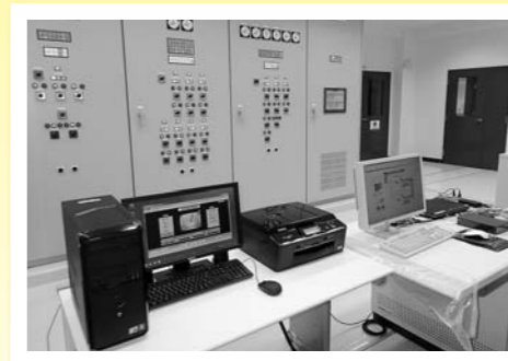
制御盤室 さまざまな機械や装置を24時間制御監視し水の状態を管理します。
