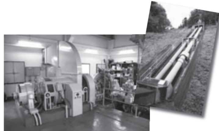
小水力発電 (西目土地改良区)
