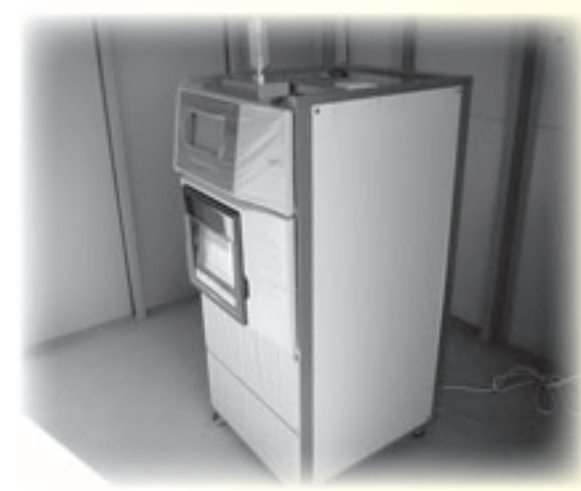
【設置された測定器】
