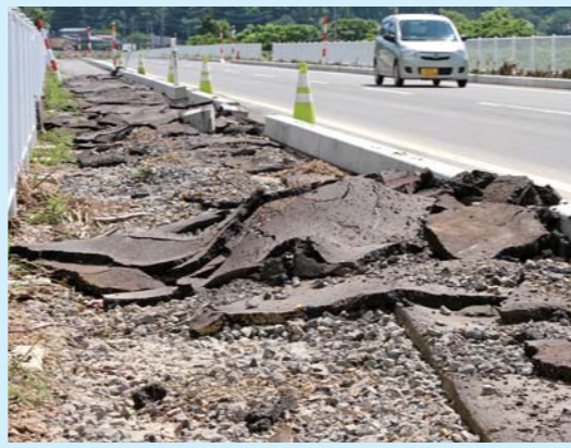
激流で損壊した歩道のアスファルト(松本)
