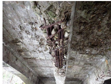
主桁の剥離・鉄筋露出
