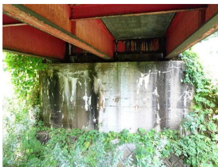
橋台の遊離石灰を伴うひびわれ
