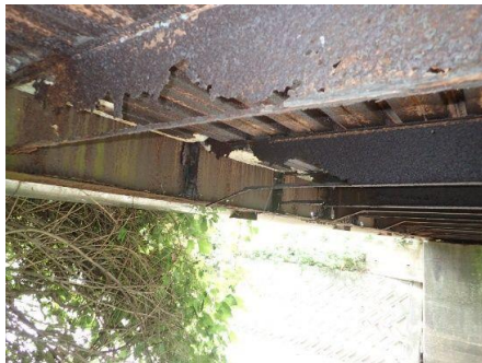
鋼桁の腐食・破断
