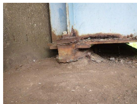
鋼製支承の沓座モルタル欠損、傾斜
