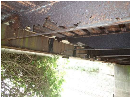
鋼桁の腐食・破断
