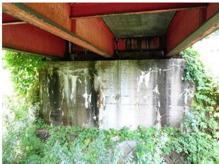
橋台の遊離石灰を伴うひびわれ
