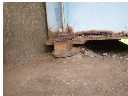
鋼製支承の沓座モルタル欠損、傾斜
