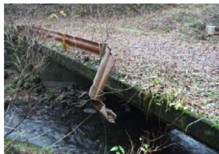
防護柵の損傷
