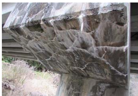
橋脚の遊離石灰を伴うひびわれ
