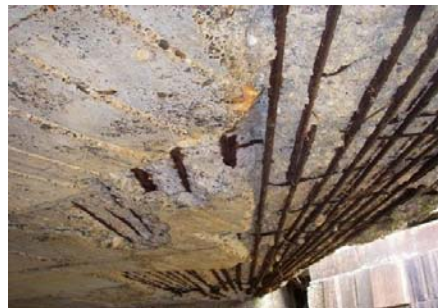
床版の鉄筋露出
