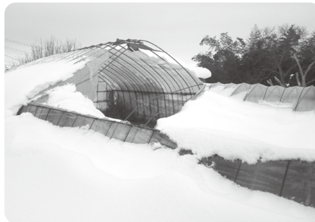
倒壊したパイプハウス
