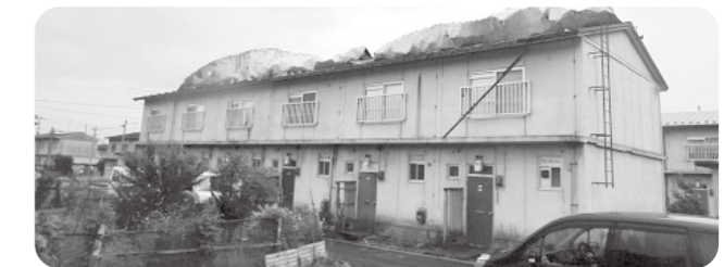
強風により屋根が剥がれた松涛団地
