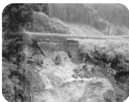
畦畔が崩落した水田
