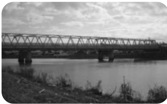
腐食により柱が破断した本荘大橋
