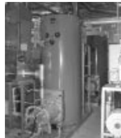
11月に視察した和歌山県内のパウダーボイラー
