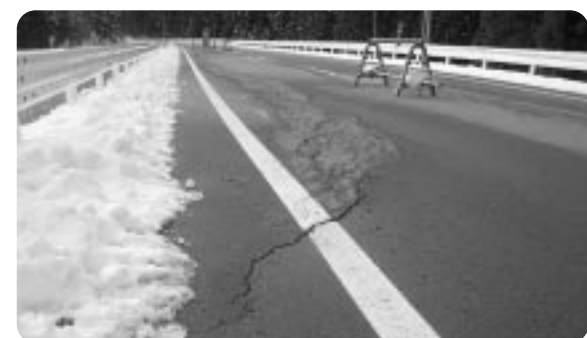
亀裂が入り通行止めとなっている鳥海グリーンライン
